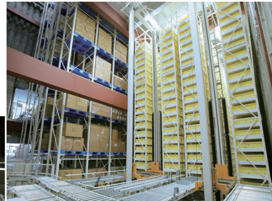
パレット保管自動倉庫（パレットスタッカー） / ピース品保管・ピッキング自動倉庫（バケットスタッカー）
