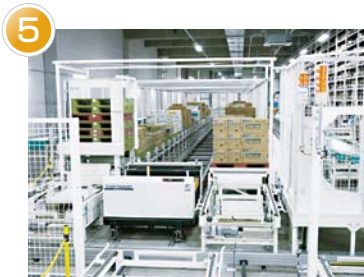
ケース出庫エリア (パレットトラバース)
